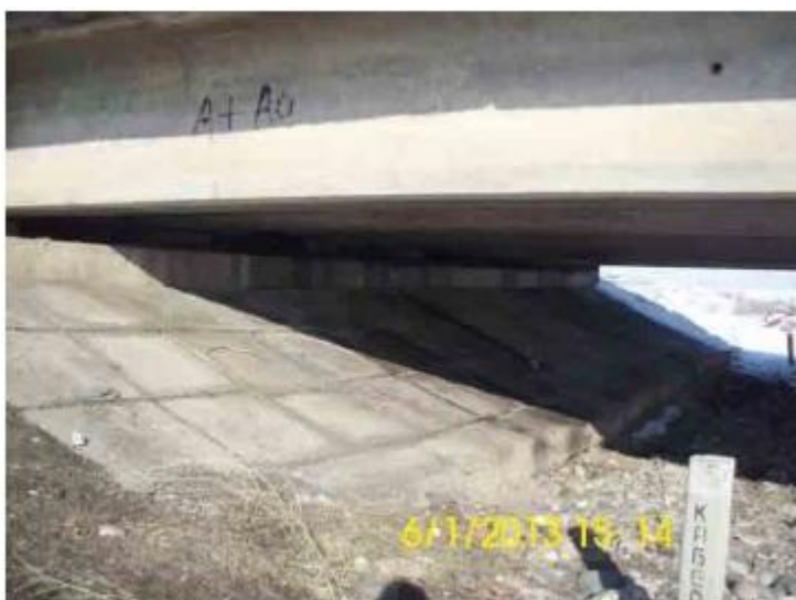
Рис. 5: Пример укрепления откосов для моста через р. Кара-Ункур
